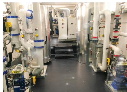
Le local technique avec, au fond, la pompe à chaleur.
